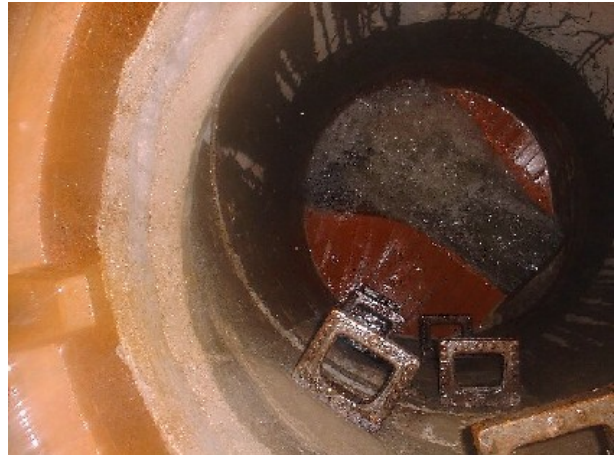
Abbildung 10: Einstau im Schacht (Bild 1)
