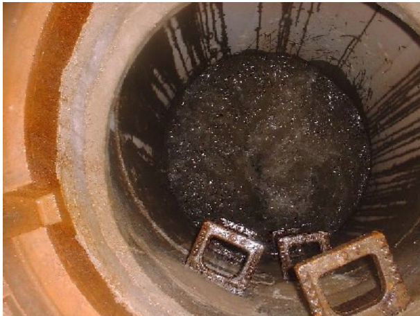
Abbildung 11: Einstau im Schacht (Bild 2)
