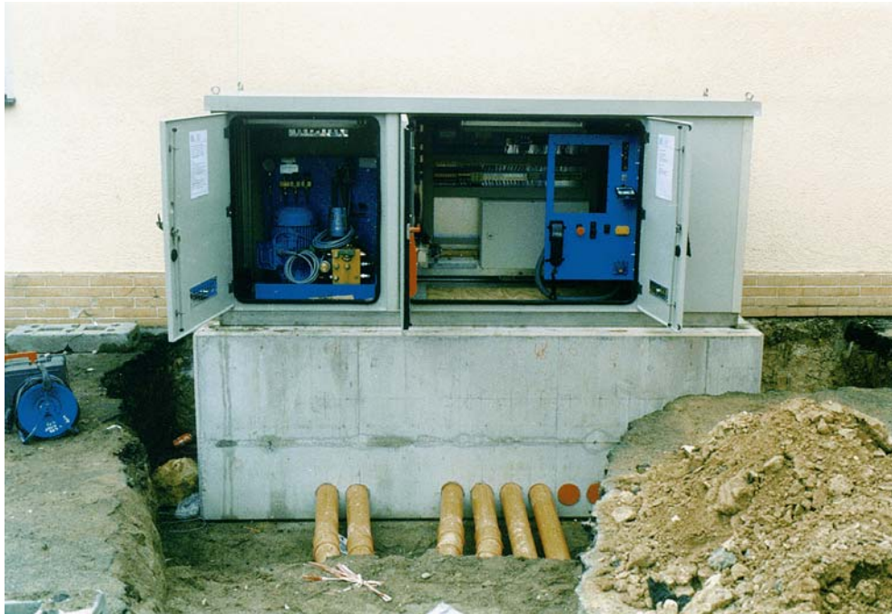
Bild 5: Schaltschrank mit Fundament und Leerrohranschlüssen
